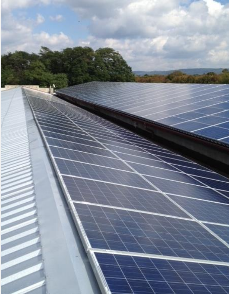
德國Malsch 540千瓦屋頂光伏系統
